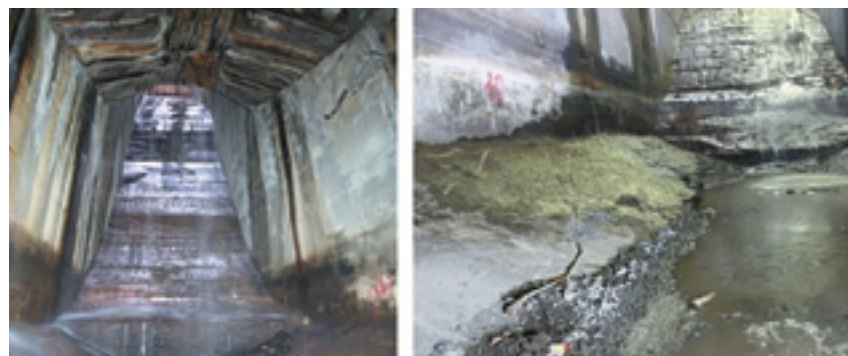
Рис. 5. Состояние входного оголовка туннеля и затопление его лотковой части
