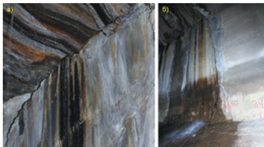
Рис. 7. Дефекты туннелей: а) фильтрационные проявления; б) разрушение межсекционного шва с активными водопоявлениями
