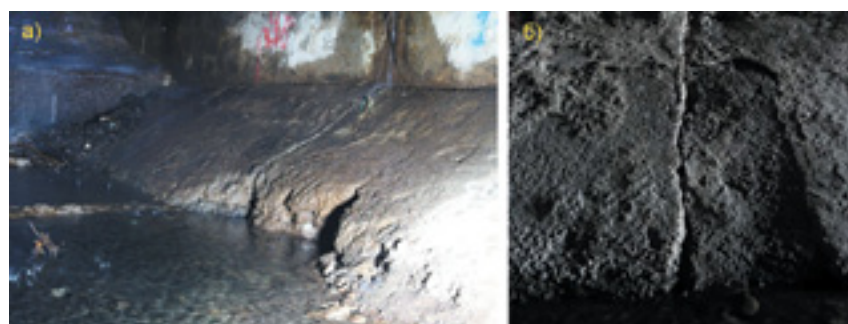
Рис. 8. Дефекты туннелей: а) вывалы с оголением арматуры; б) трещины с раскрытием до 10 мм
