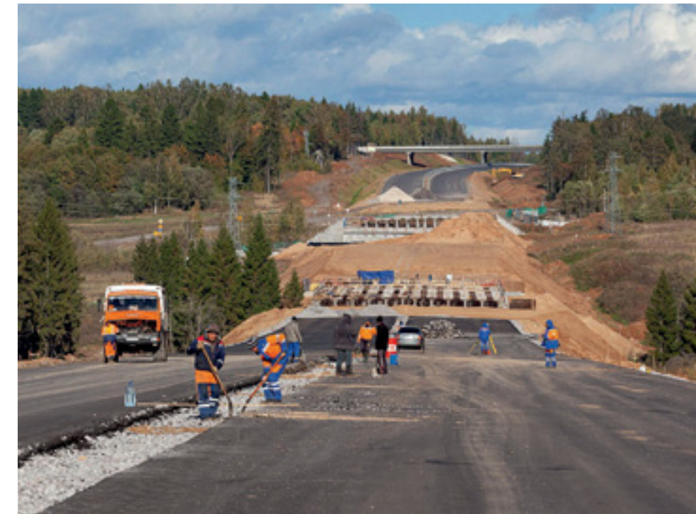
В процессе эксплуатации ИССО, а, зачастую, в ходе строительства возникают дефекты, которые требуют своевременного устранения.
